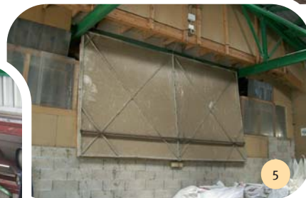
Porte motorisée entre stockage et bergerie.
