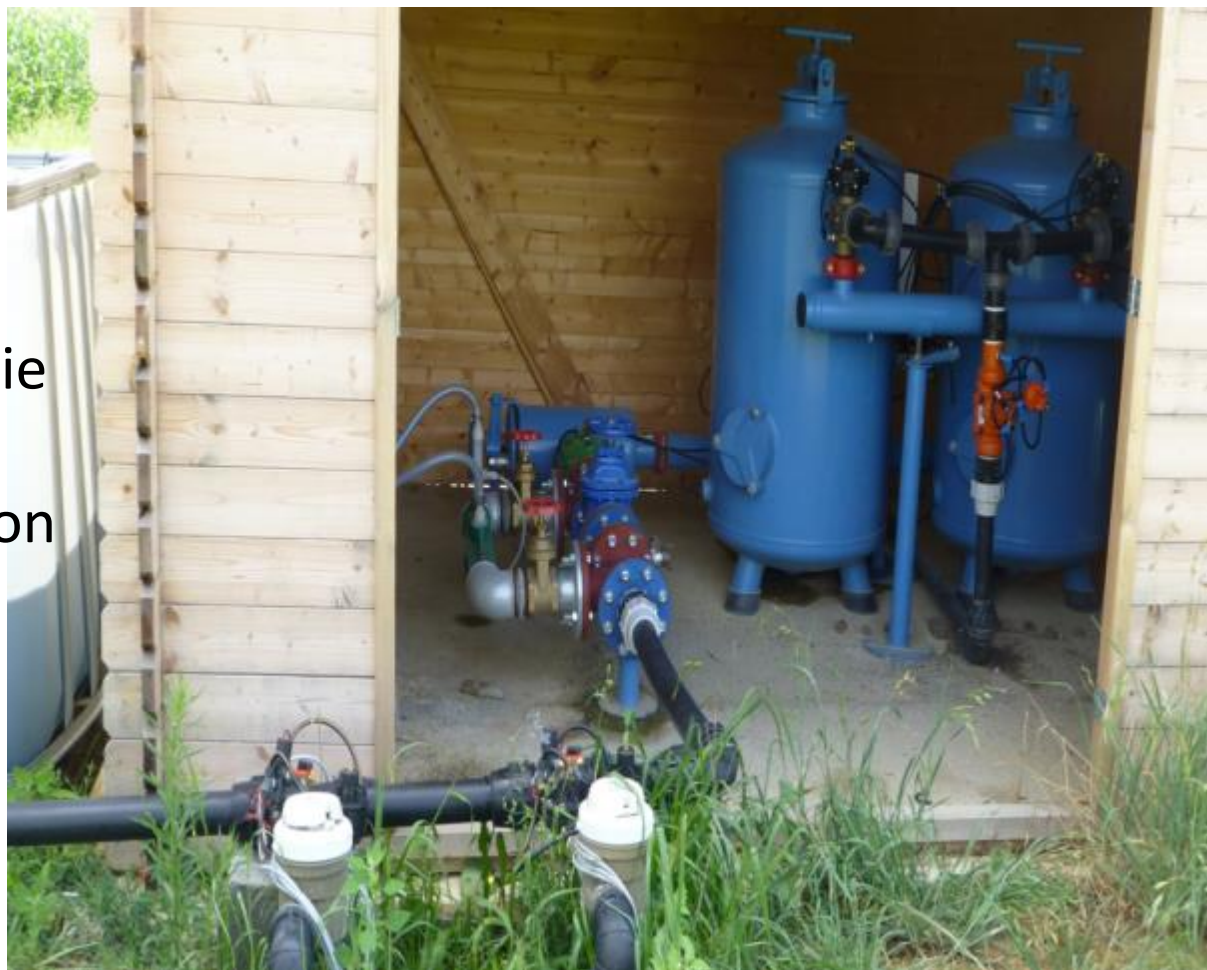
Installation de filtration : 1,2 à 3 bars
