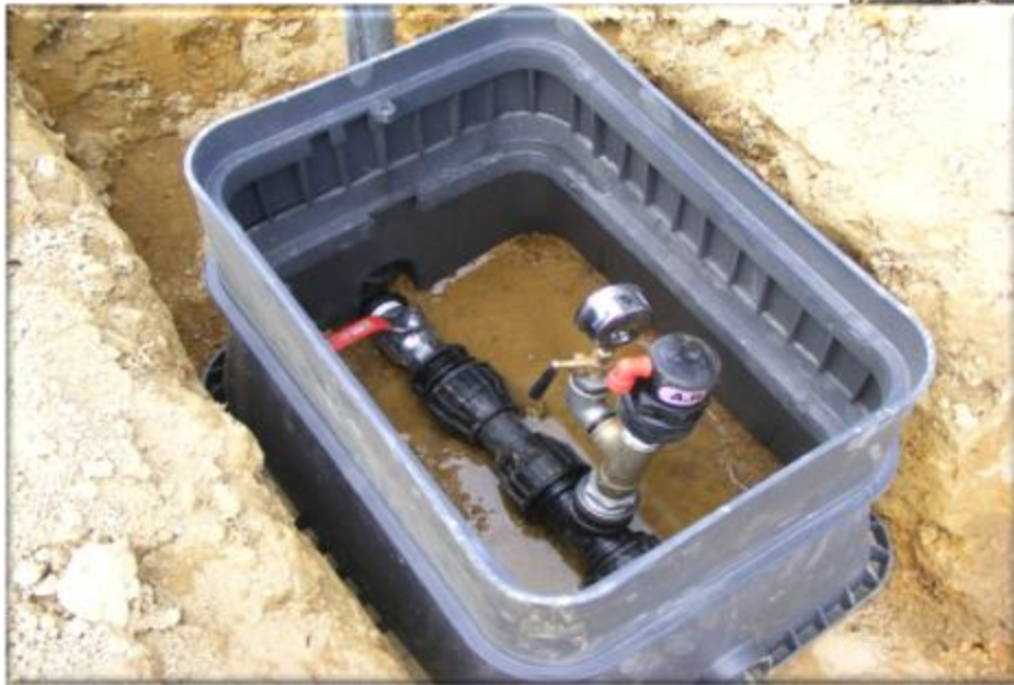
Extrémité des collecteurs avec ventouse, prise de pression et vidange
